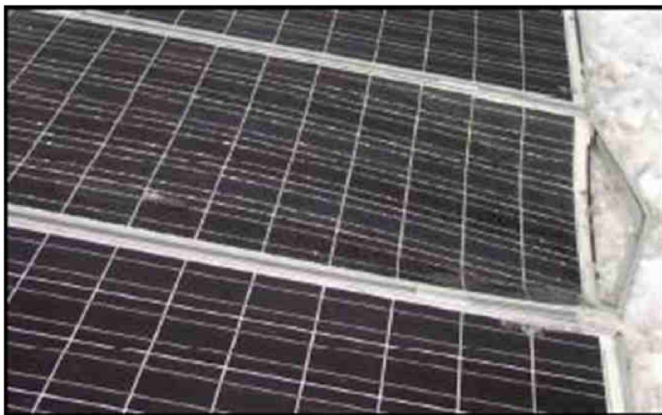
Obr. 2.3-3 Promáčknutý FV panel a ohnutý rám [18]
