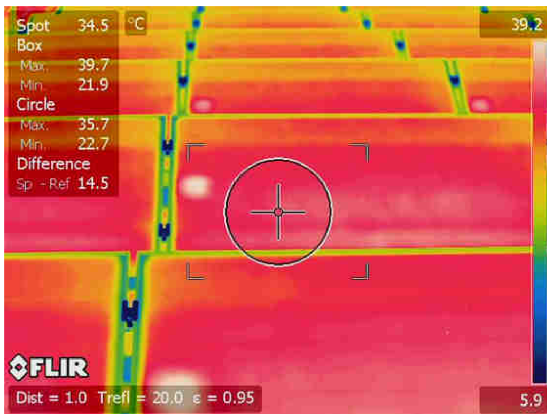
Obr. 5.2-9 Termovizní pohled na část FV pole
