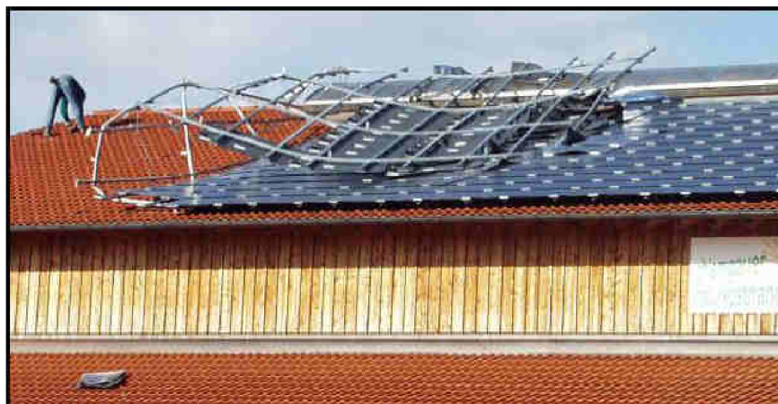
Obr. 2.3-2 FV elektrárna poškozená účinky větru [18]
