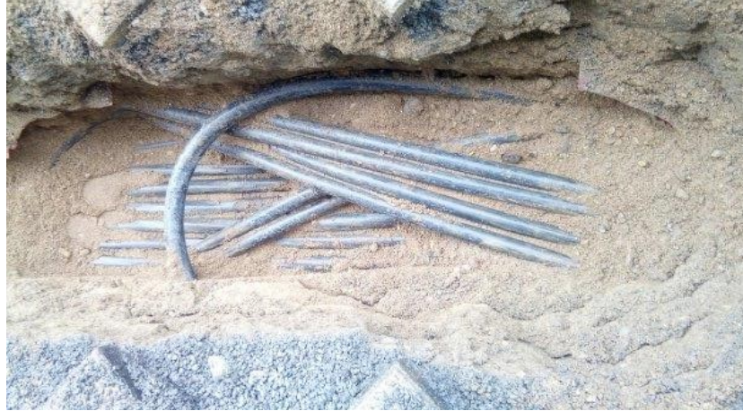
Obr. 5-4 Porucha č.2: VN 1210, výkopové práce, Sukova
