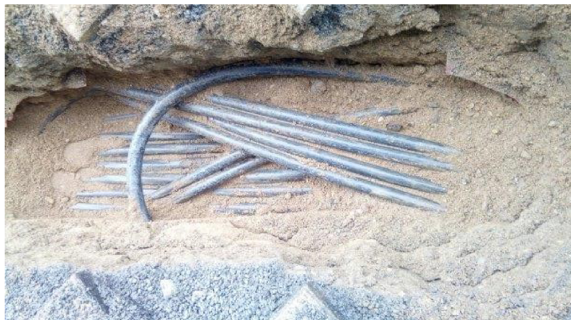
Obr. 5-4 Porucha č.2: VN 1210, výkopové práce, Sukova
