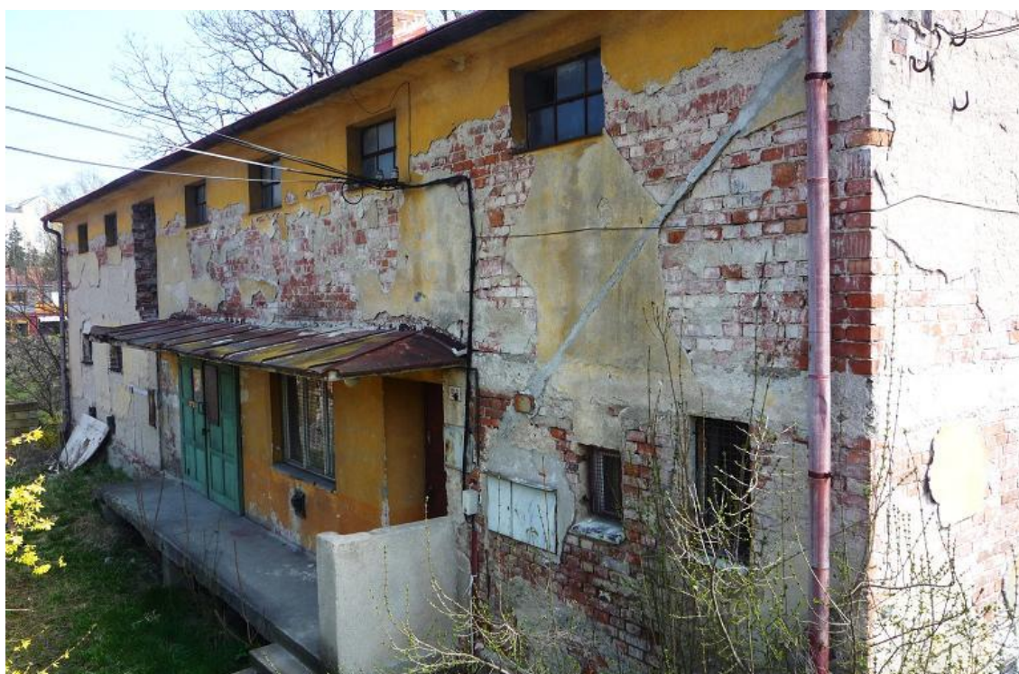
Obr. 14: Chátrající budova bývalého obchodu smíšeného zboží (zdroj: vlastní fotodokumentace)
