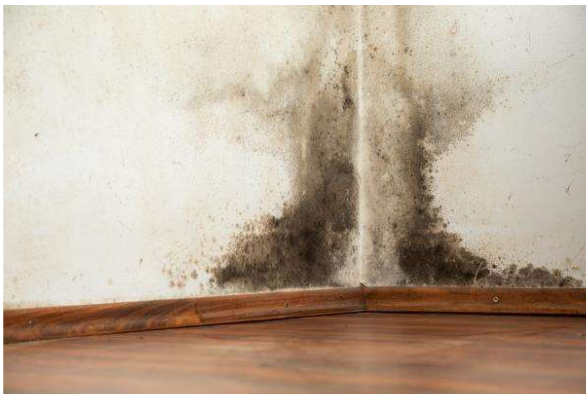
Obrázek 6 Plíseň způsobená špatným zateplením KZS, Zdroj (12)
