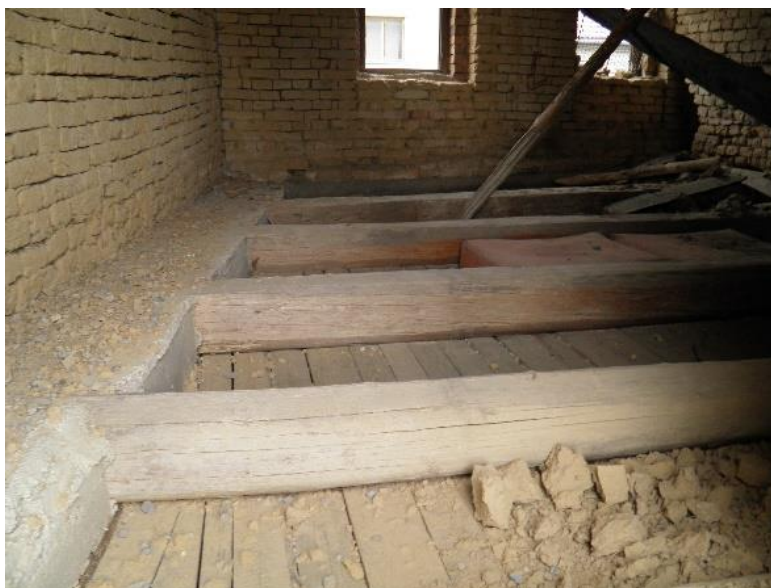
Obr. 4.17 Uložení stropních trámů a chybějící podlaha
