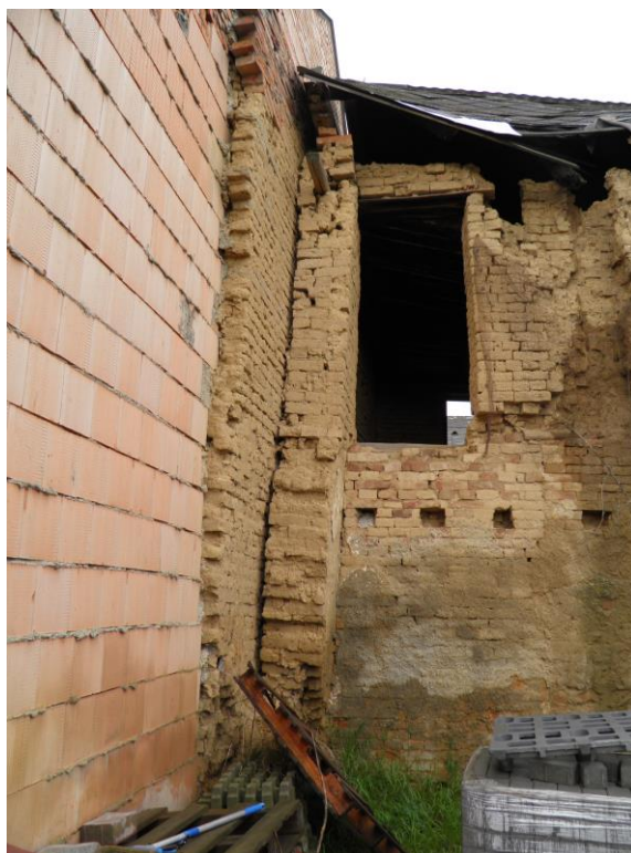
Obr. 4.13 Dilatační spára a kapsy po trámech
