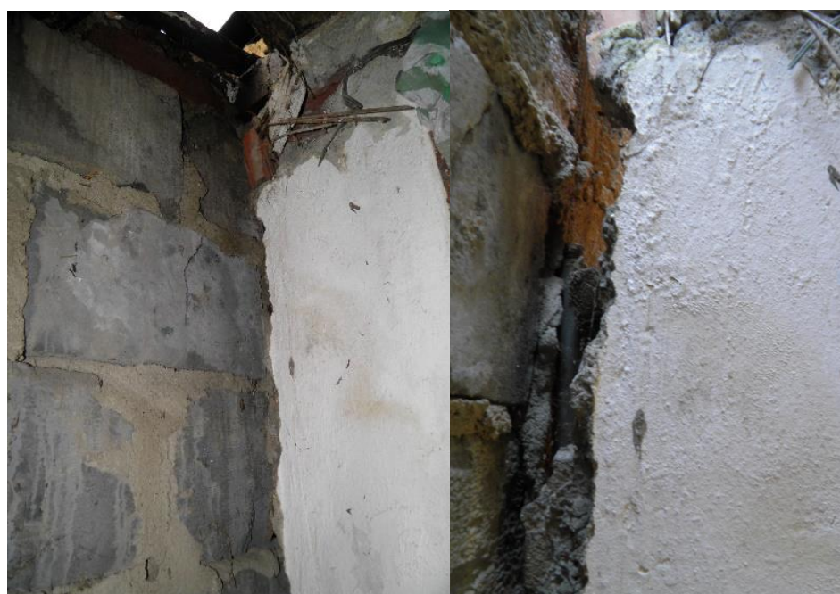
Obr. 4.11 Chybějící vazba příčky
