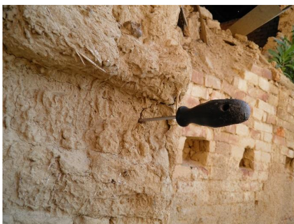
Obr. 4.12 Vrypová zkouška na nepálené cihle
