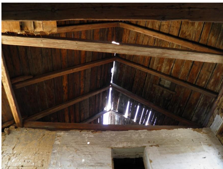
Obr. 4.18 Krov a poškození střešního pláště
