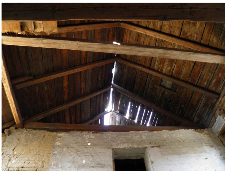
Obr. 4.18 Krov a poškození střešního pláště
