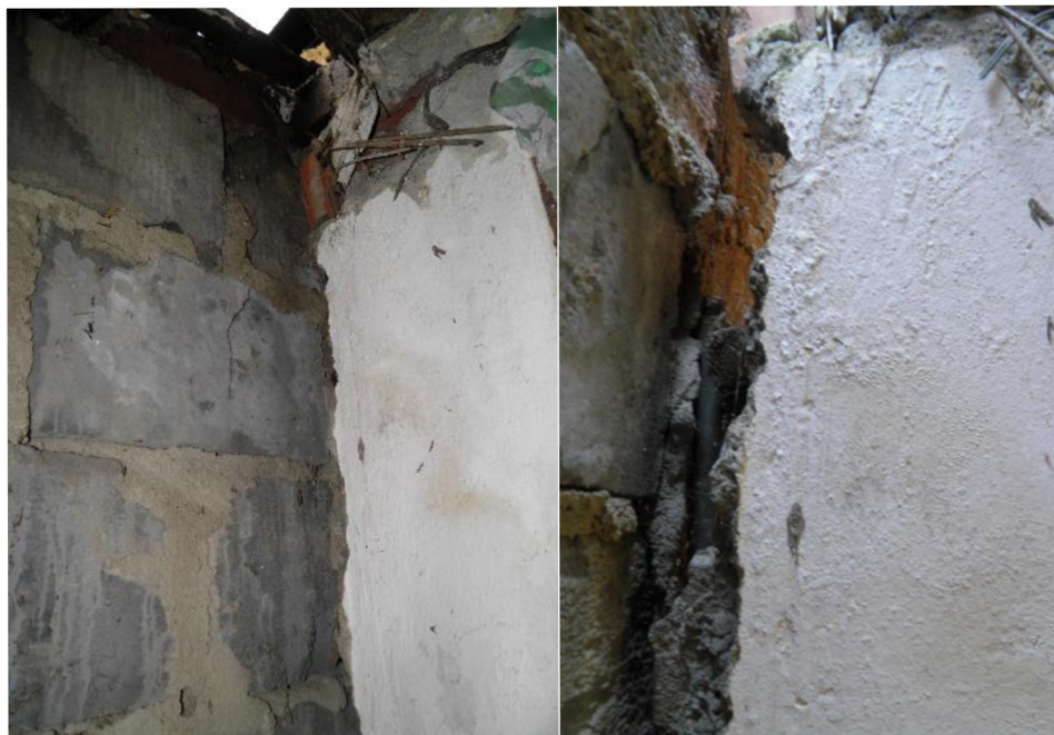
Obr. 4.11 Chybějící vazba příčky
