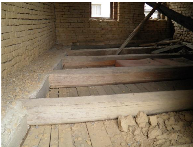
Obr. 4.17 Uložení stropních trámů a chybějící podlaha
