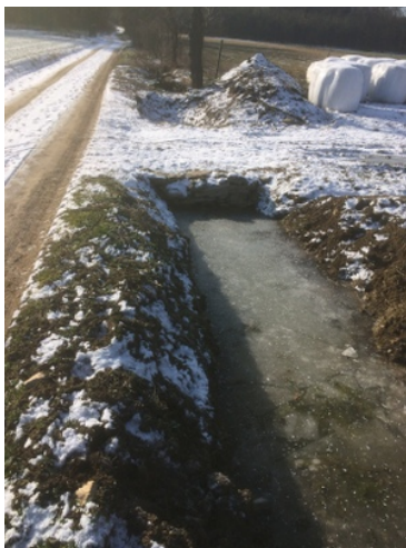
Obrázek 30- zanesený propustek P3
