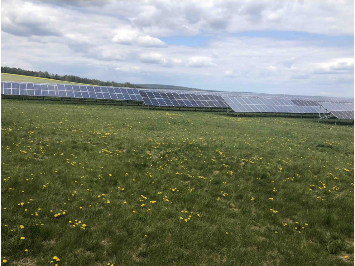
Příloha 1 Fotovoltaická elektrárna Ochoz
