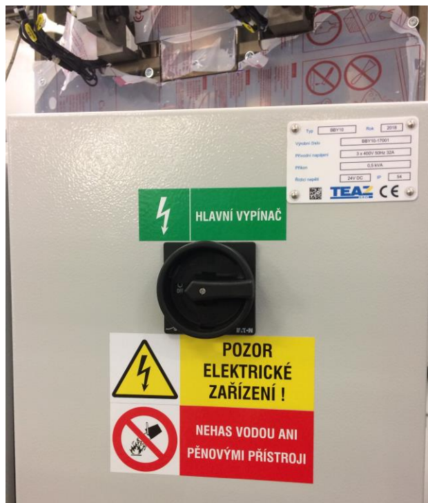
Obr. 3) Otočný přepínač jako hlavní vypínač rozvaděče jednoúčelového stroje [10]
