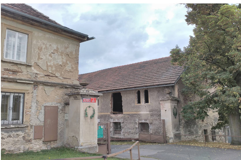
Obr. 91: Stavení č. p. 1 (b) na bývalém tržišti (B) se nachází ve špatném stavu. Vpravo vzrostlá lípa (2). (fotografie vlastní)
