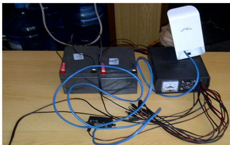
Obr. 3.9: Ukázka vlastní realizace navrženého záložního zdroje – 12V s PSC-60.
