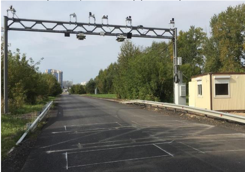
Obr. 1 – Mýtná brána pro automatizovaný systém kontroly vážení a rozměrů
