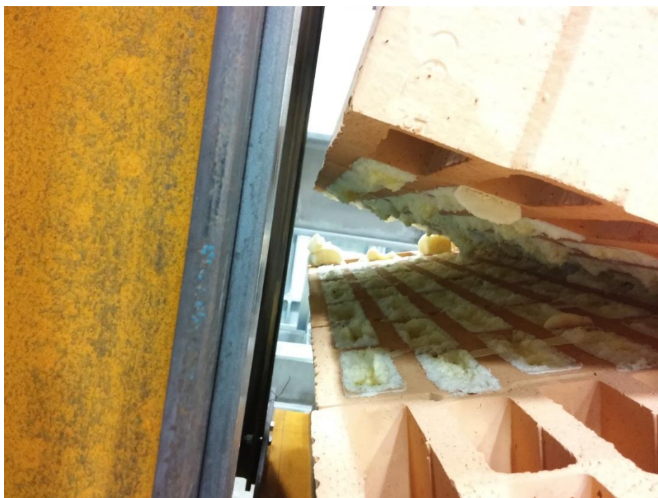
Obrázek č. 31 – Detail porušení
