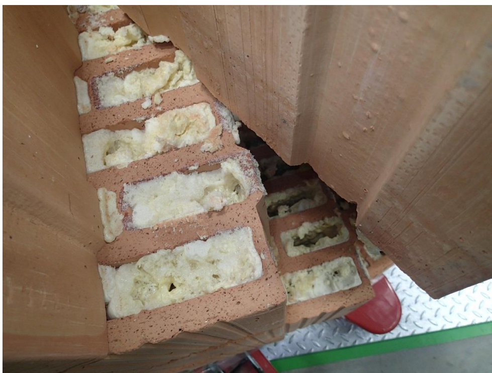
Obrázek č. 28 – Detail porušení
