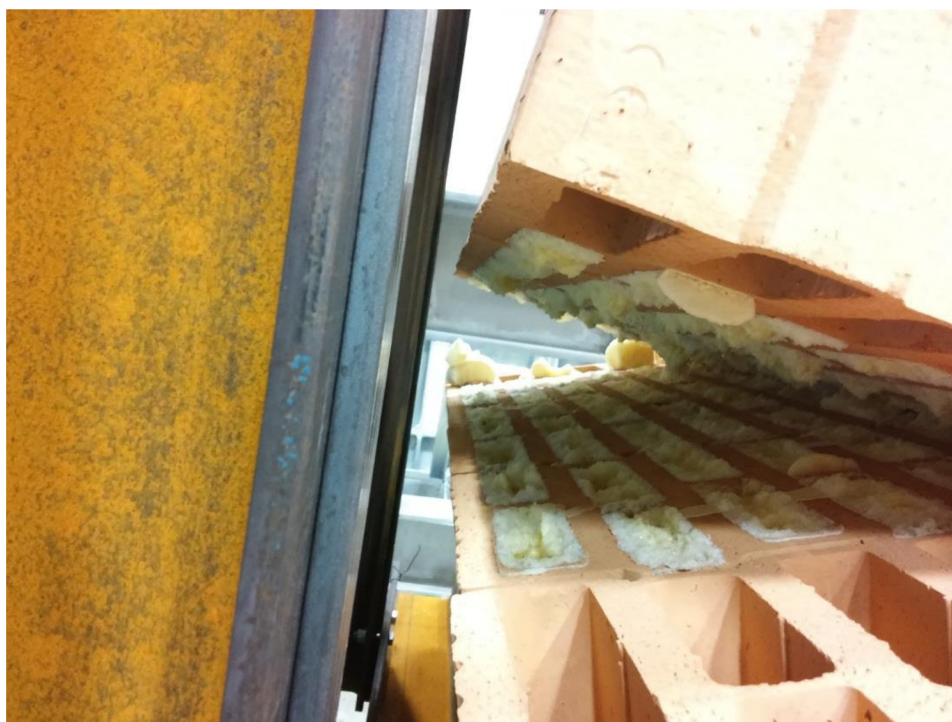
Obrázek č. 31 – Detail porušení
