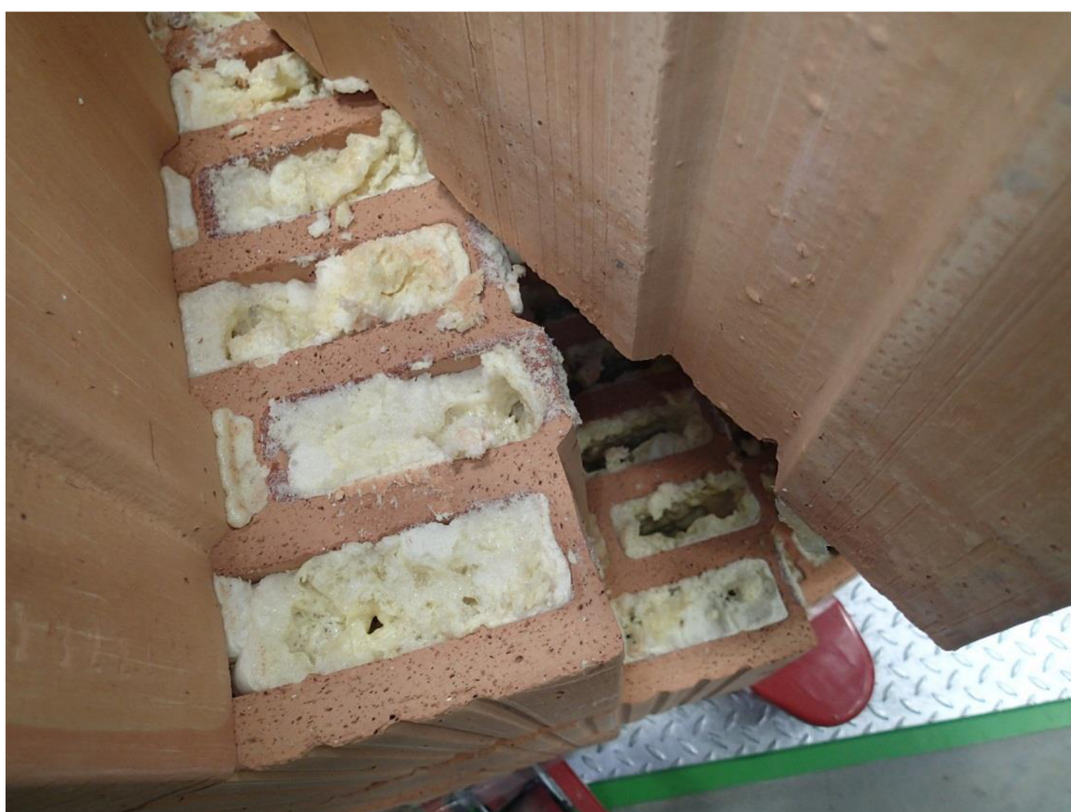
Obrázek č. 28 – Detail porušení
