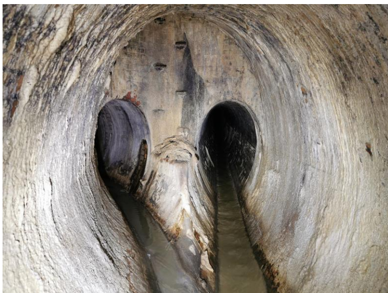
Obr. 8-6 - spojná komora Š18SK [zdroj: Lukáš Havlíček]
