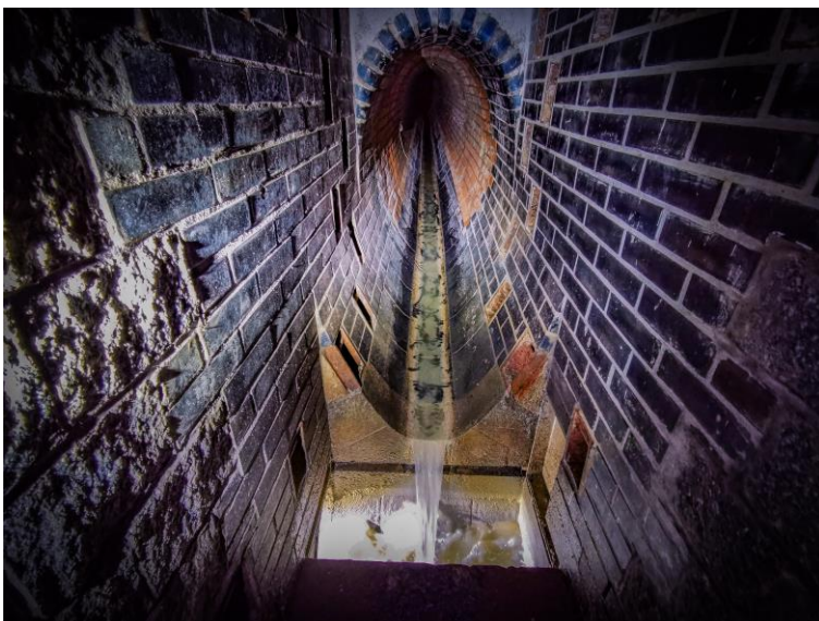
Obr. 9-10 – pohled na štěrbinovou oddělovací komoru spadiště Nad Novou Libní [zdroj: Lukáš Havlíček]
