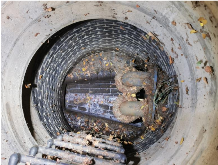
Obr. 8-42 – pohled na konec výtlačných potrubí 2xDN110 ČS Bohnická II [zdroj: Lukáš Havlíček]
