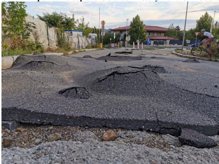
Obr. 9-8 – pohled na zničený povrch komunikace – ulice Jiřího Jandy [zdroj: Lukáš Havlíček]
