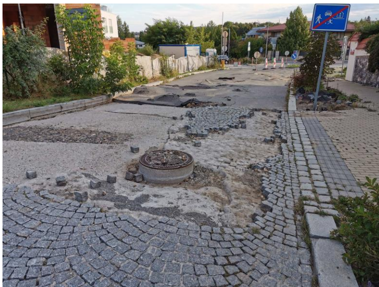
Obr. 9-7 – pohled na odplavené dlažební kostky v ulici Jiřího Jandy [zdroj: Lukáš Havlíček]
