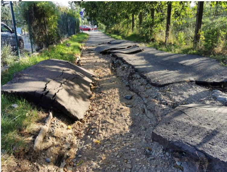
Obr. 9-6 – pohled na destrukci chodníku u zázemí botanické zahrady [zdroj: Lukáš Havlíček]
