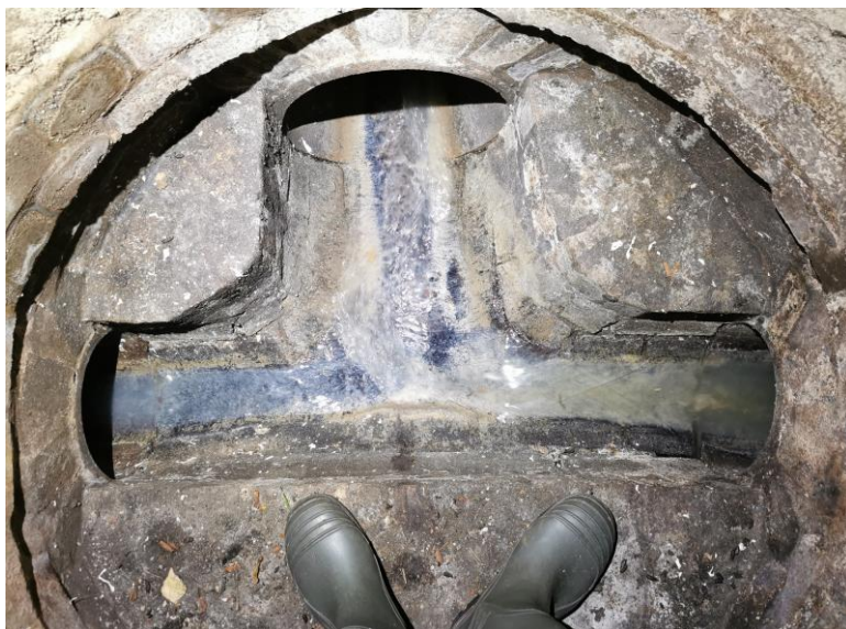
Obr. 8-34 – pohled na spojnou šachtu a začátek stoky Hnězdenská [zdroj: Lukáš Havlíček]
