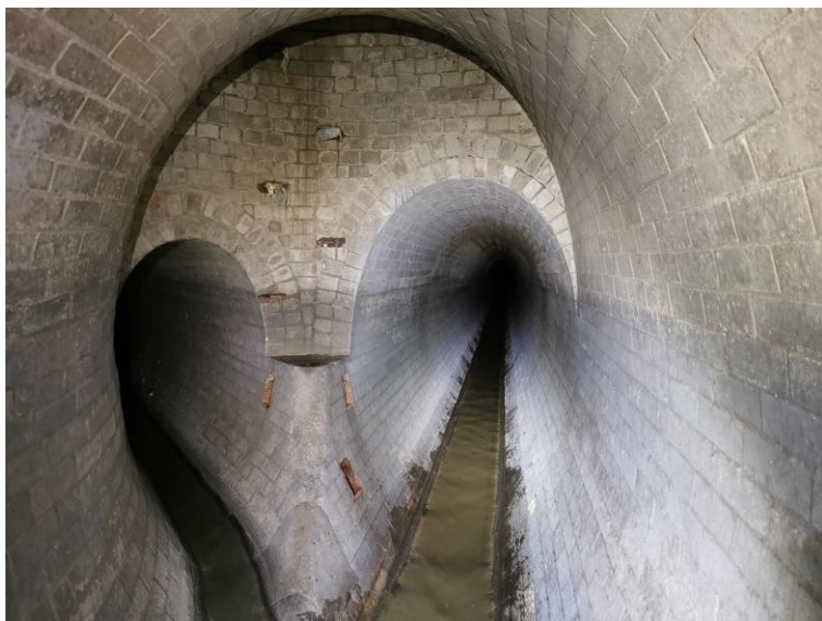
Obr. 8-8 - spojná komora Š2SK [zdroj: Lukáš Havlíček]
