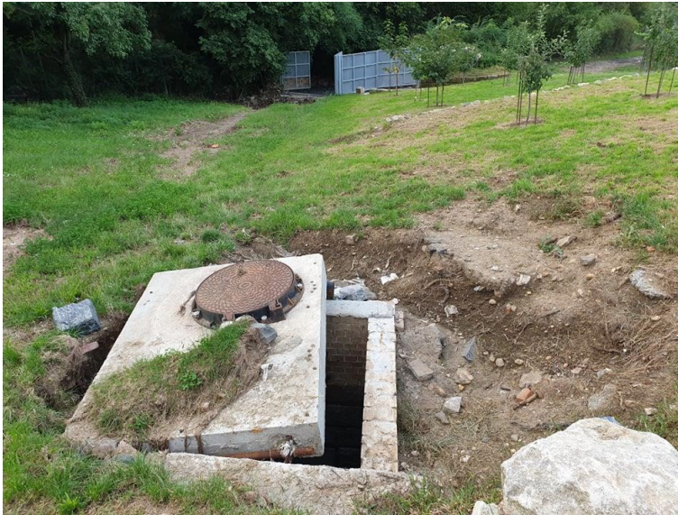
Obr. 9-3 – pohled na odsunutou stropní desku spadiště a poškozený terén v okolí [zdroj: Lukáš Havlíček]
