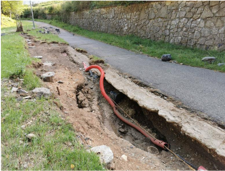
Obr. 9-5 – pohled na obnažené elektrické vedení, na erozní rýhu a na odplavené kameny. [zdroj: Lukáš Havlíček]
