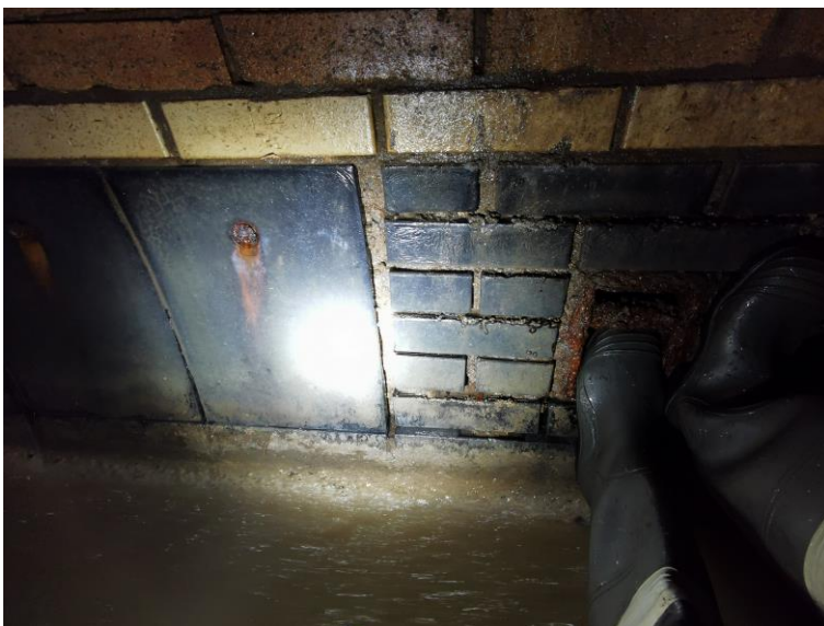
Obr. 9-9 – pohled na degradaci pojiva vyzdívky [zdroj: Lukáš Havlíček]
