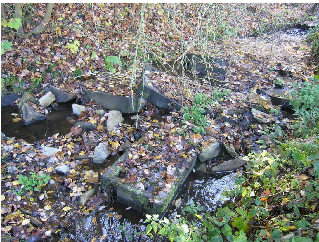
Obrázek 13: Nahromaděné vytrhané polovegetační tvárnice, první úsek (zdroj: vlastní)
