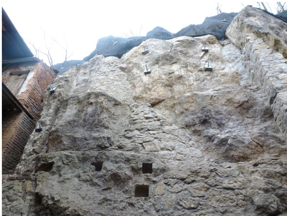
Obr.69 Krnsko - sanace skalní stěny v zadním traktu obytného domu, kombinace podezdívek, plomb a kotvení v kalliánosových vápnatých pískovcích (archiv autora)
