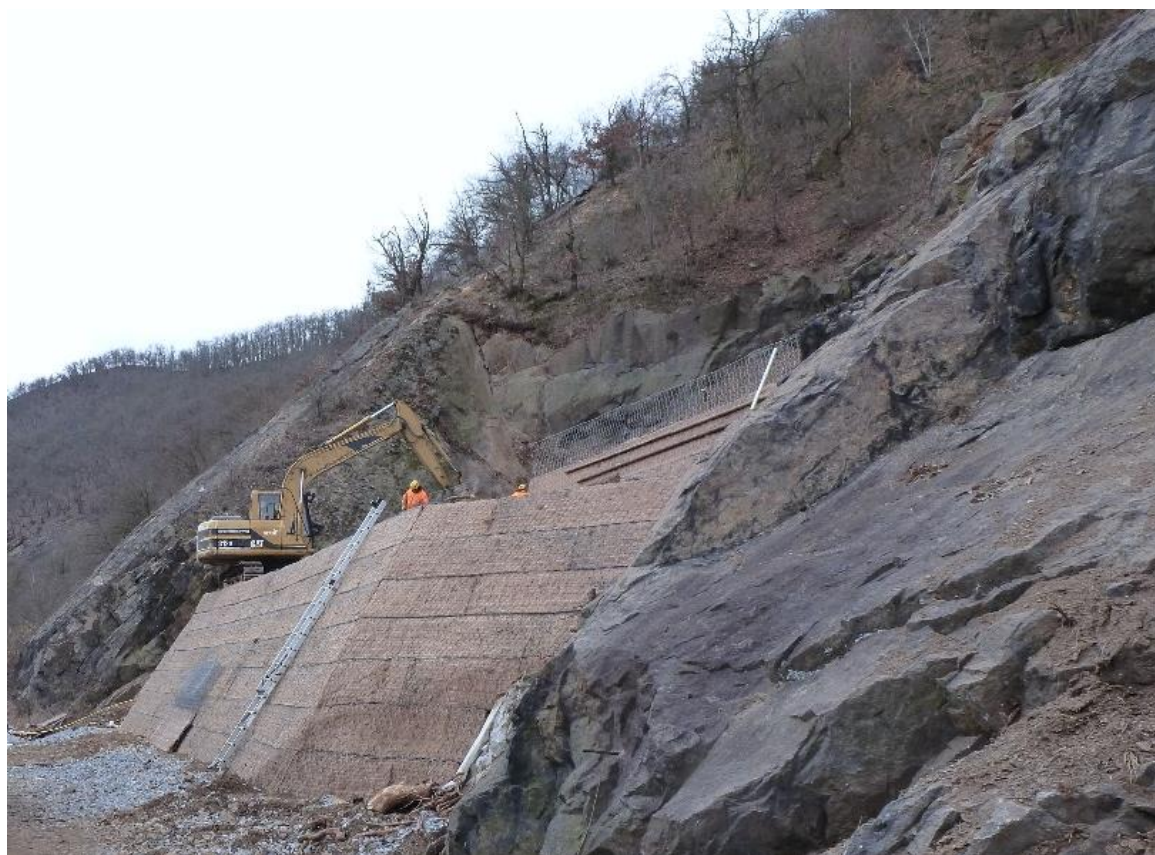
Obr.48 Silnice II/102 v úseku Strnady-Měchenice; vyztužený val – první realizace v ČR (archiv autora)
