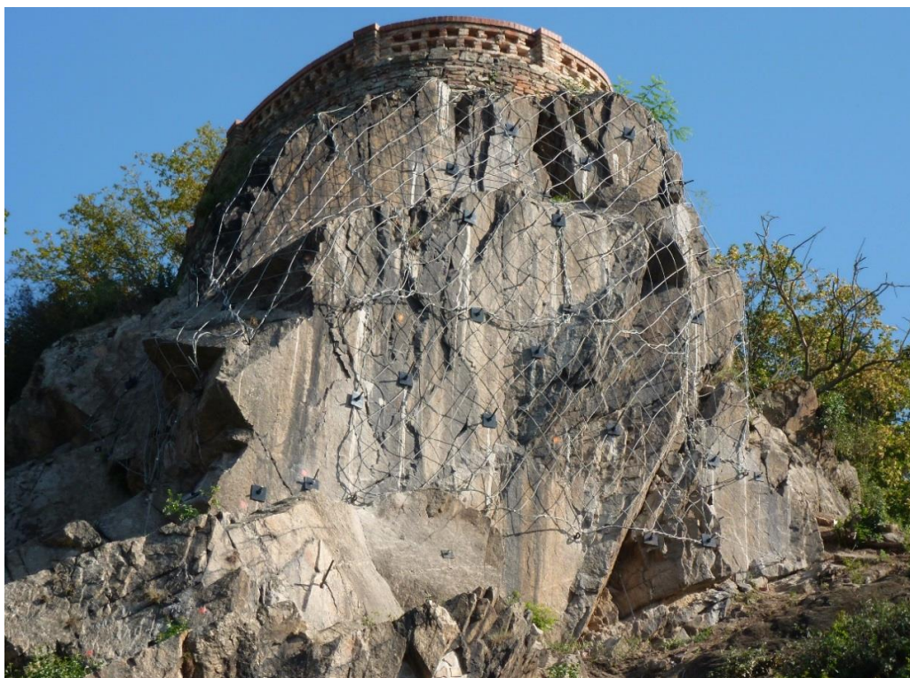
Obr.81 Zajištění skalní vyhlídky pod Znojemským hradem lanovými sítěmi, dyjský masiv (archiv autora)
