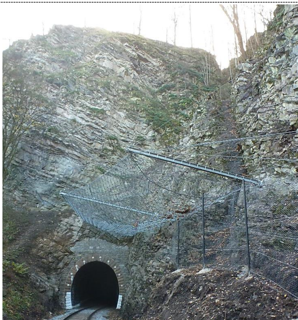
Obr.22 Doubravnický tunel na trati č. 251 Žďár n. S. – Tišnov v km 85,200; modifikovaná galerie doubravnického portálu tvořená dynamickou bariérou výšky 8,0 a 3,0 m (archiv autora)
