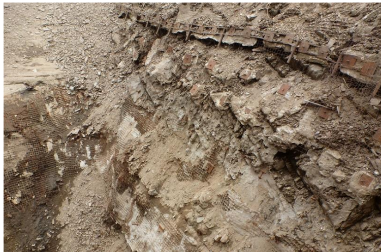
Obr.106 PVE DS, destrukce SB s obnaženými kotevnými tyčemi, levá strana objektu (archiv autora)
