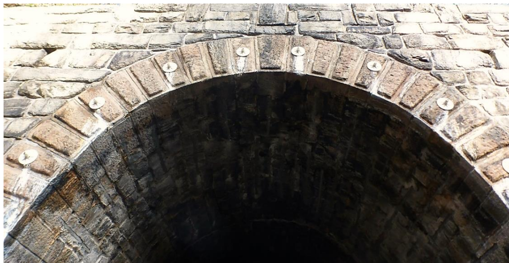
Obr.87 Doubravnický tunel, trať č. 251 Žďár n. S. v km 85,200 - kotvení obezdívky boračského portálu sklolaminátovými svorníky (archiv autora)
