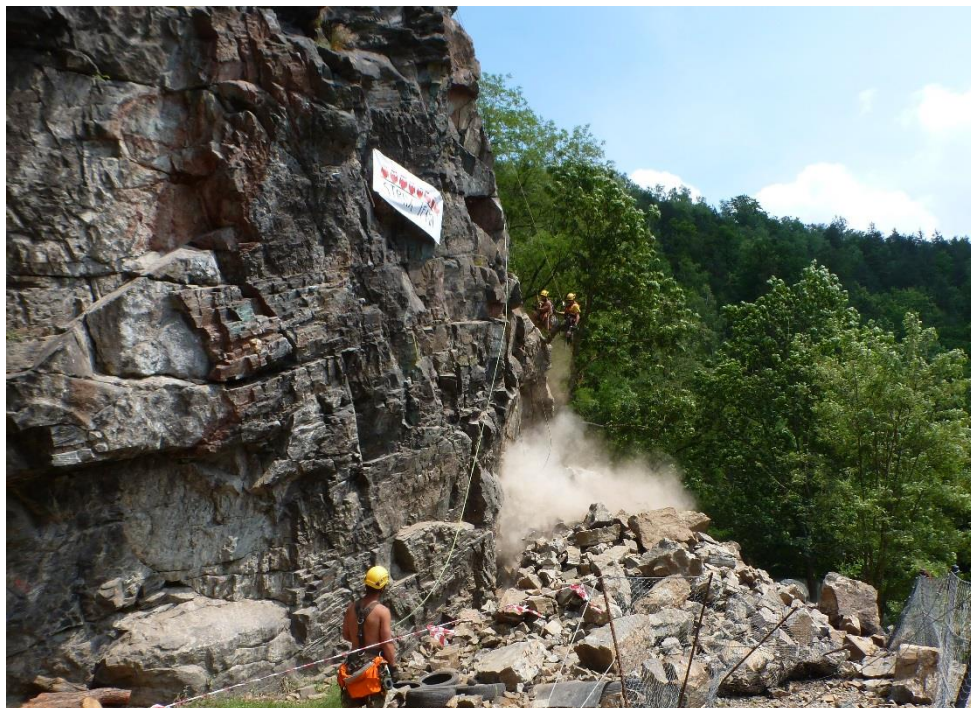
Obr.67 Havarijní odtěžení a reprofilace části Barevné skály v Českém Krumlově (archiv autora)
