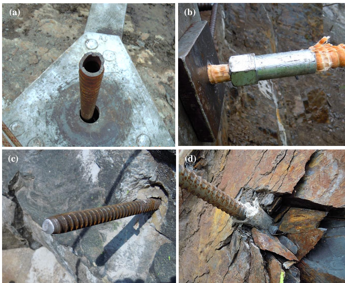
Obr.91 Ukázka porušení na mezi pevnosti tyče I (a), tyče C (c), porušení na mezi pevnosti závitu tyče R (b) a porušení na rozhraní zálivka/hornina (d)
