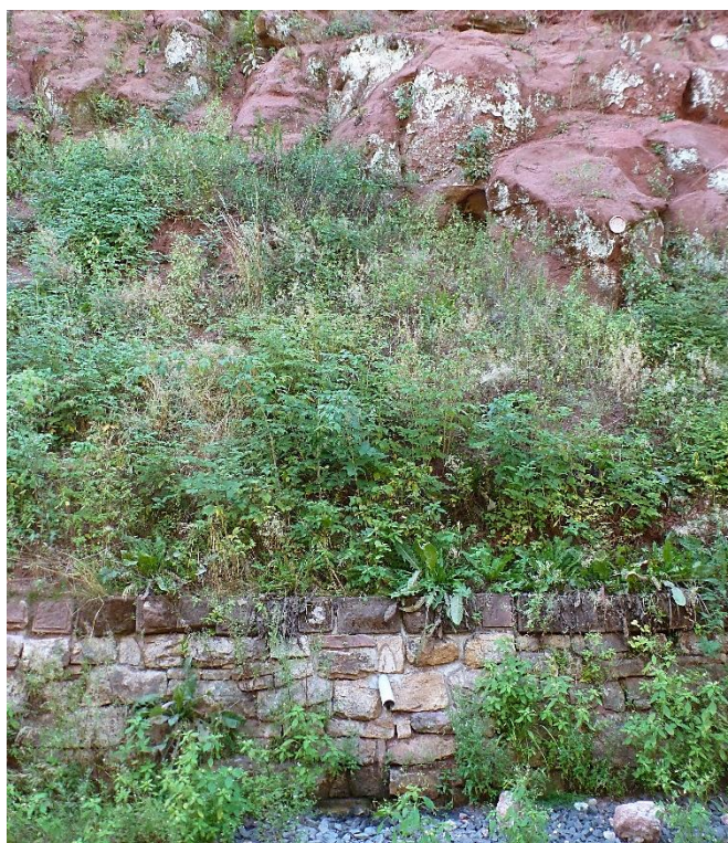
Obr.71 Soustředná drenáž, trať Jaroměř - Liberec (archiv autora)
