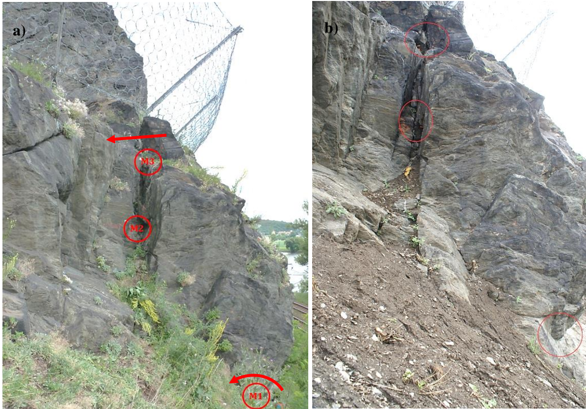
Obr.25a,b Trať Všetaty – Děčín, stav při osazení bodů s naznačením pohybu (a) a stav těsně po sanaci (b) (archiv autora)
