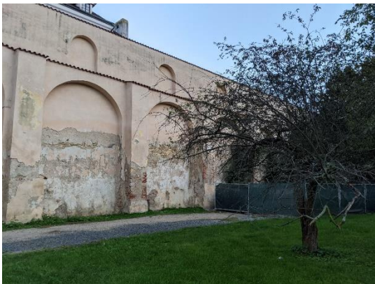
Příloha 7 - Pohled na nevhlednou klauzurní zeď (zdroj: Tereza Nidetzká)
