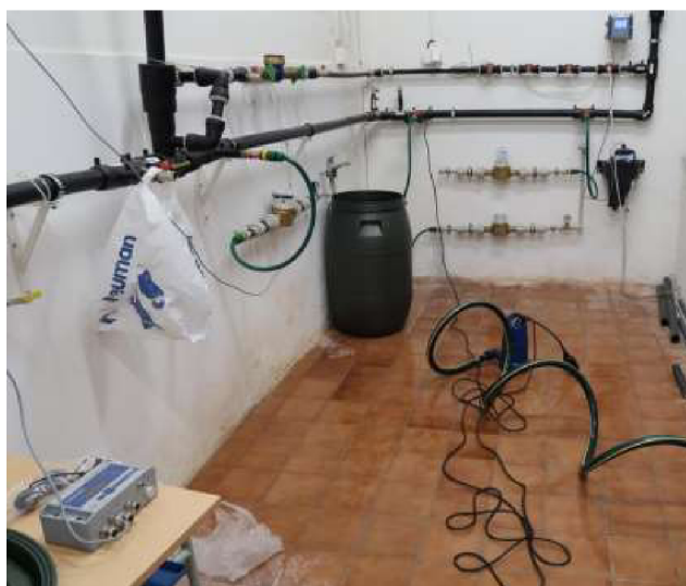
Obr 4.1 Ukázka instalovaného měření při testování
