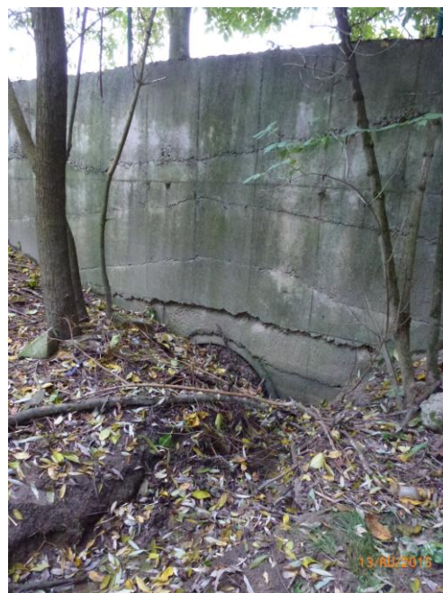
Odběrný profil 2 – pohled na zanesený trubní propustek
