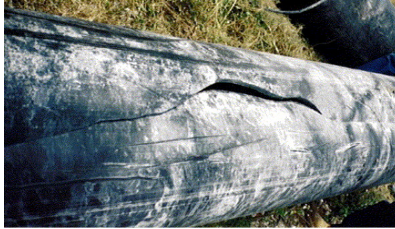
Obr. 11: Pozdĺžna trhlina, HDPE trubka [35]
