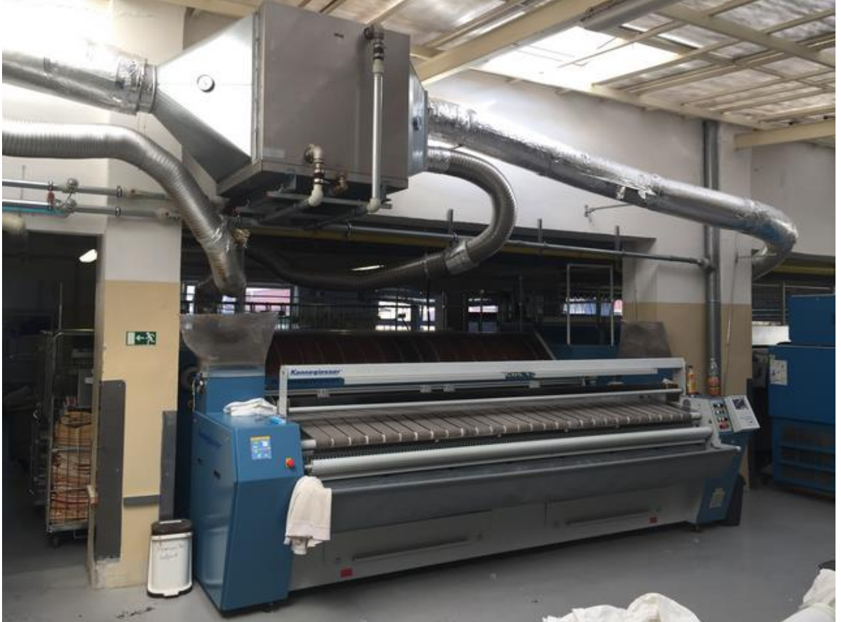
Obrázek 6 - Žehlicí stroj (mandl) Kannegiesser a nad ním tepelný výměník T2 (vzduch-voda).
