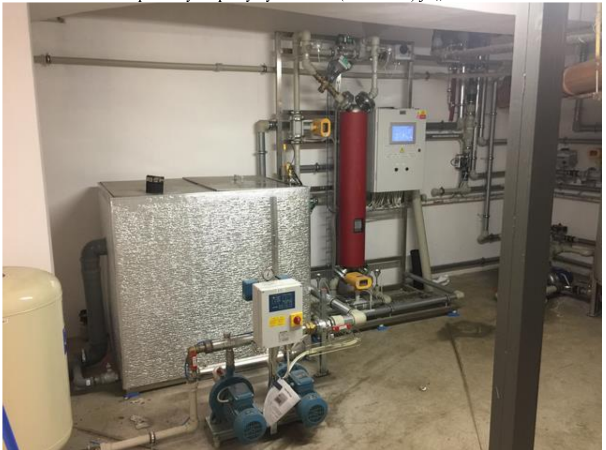
Obrázek 3 – Kotelna prádelny. Tepelný výměník T1 (voda-voda) je „srdcem“ celé inovace.
