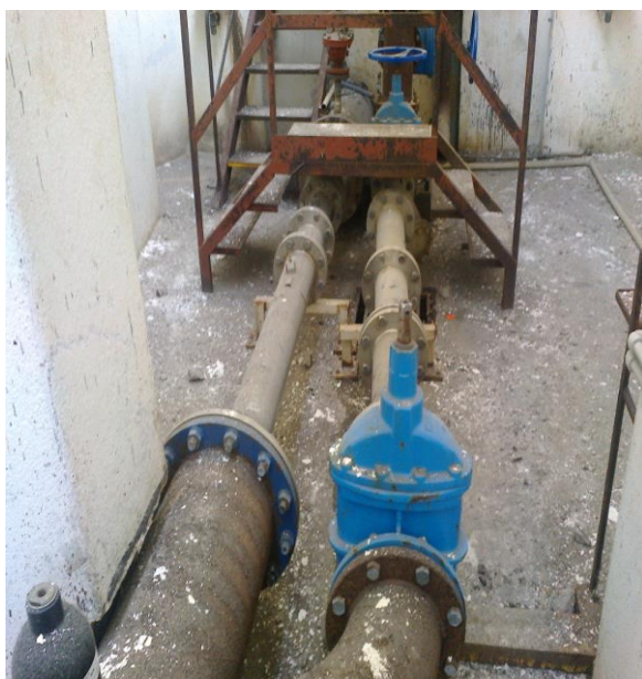
Obrázek 12.4 - Původní potrubí v AK
