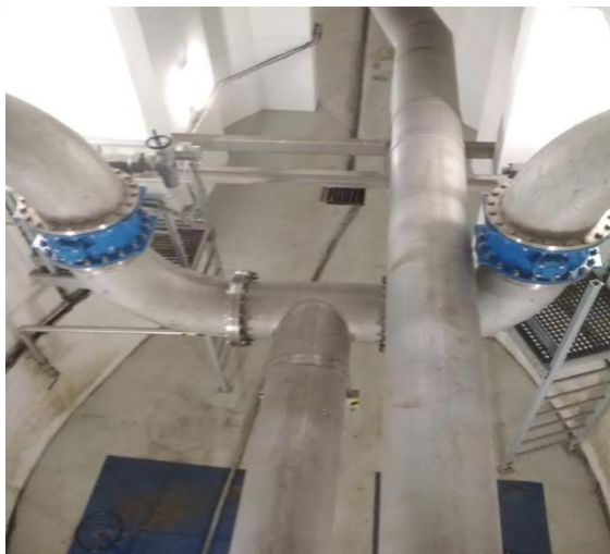
Obrázek 12.5 - Současné potrubí z nerez oceli
