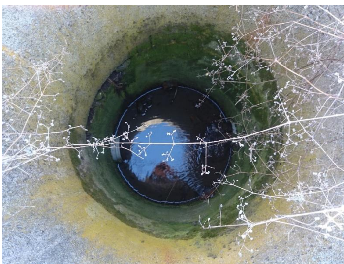
Obr. 17: Kontrolní šachtice č. 2, [Fotodokumentace: vlastní]
