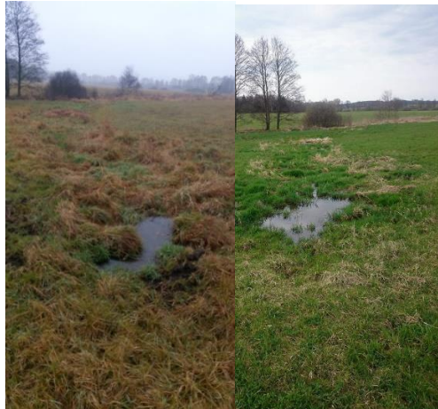
Obr. 15: Zamokřené místo od výusti po 1. kontrolní šachtici, [Fotodokumentace: zpracování vlastní, podzim 2016, jaro 2017]
