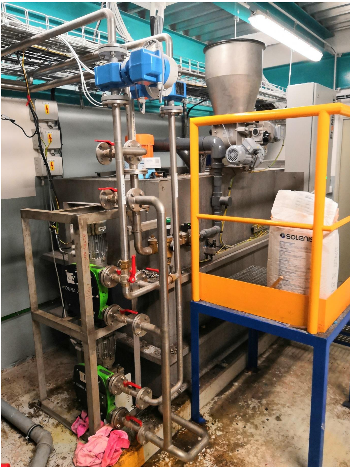
Obrázek 9: Flokulační stanice Mn vod (vlastní foto)
