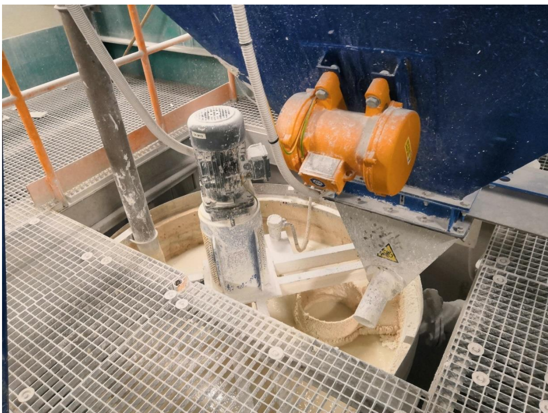
Obrázek 7: Rozplavovací nádrž vápenného mléka (vlastní foto)
