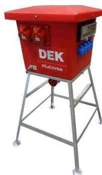
Obrázek 33: Hlavní staveništní rozvaděč [10]
