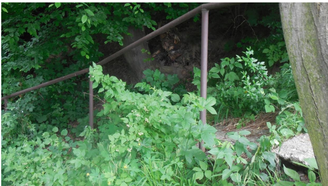
Obr. č. 53 Přístupová cesta ke studni, zábradlí a schůdky v nevyhovujícím stavu
