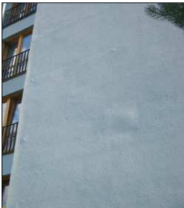
Obrázek. č. 21 – Boule na provedeném zateplení [41]
