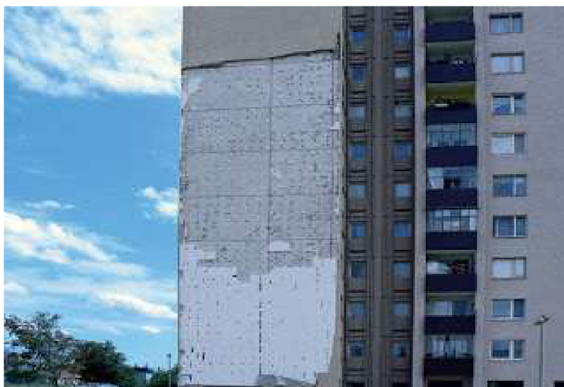
Obrázek. č. 19 – Nekvalitně provedené zateplení [41]
