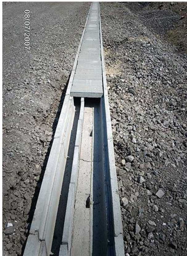
Obr. 2.7: Betónový káblový žľab
