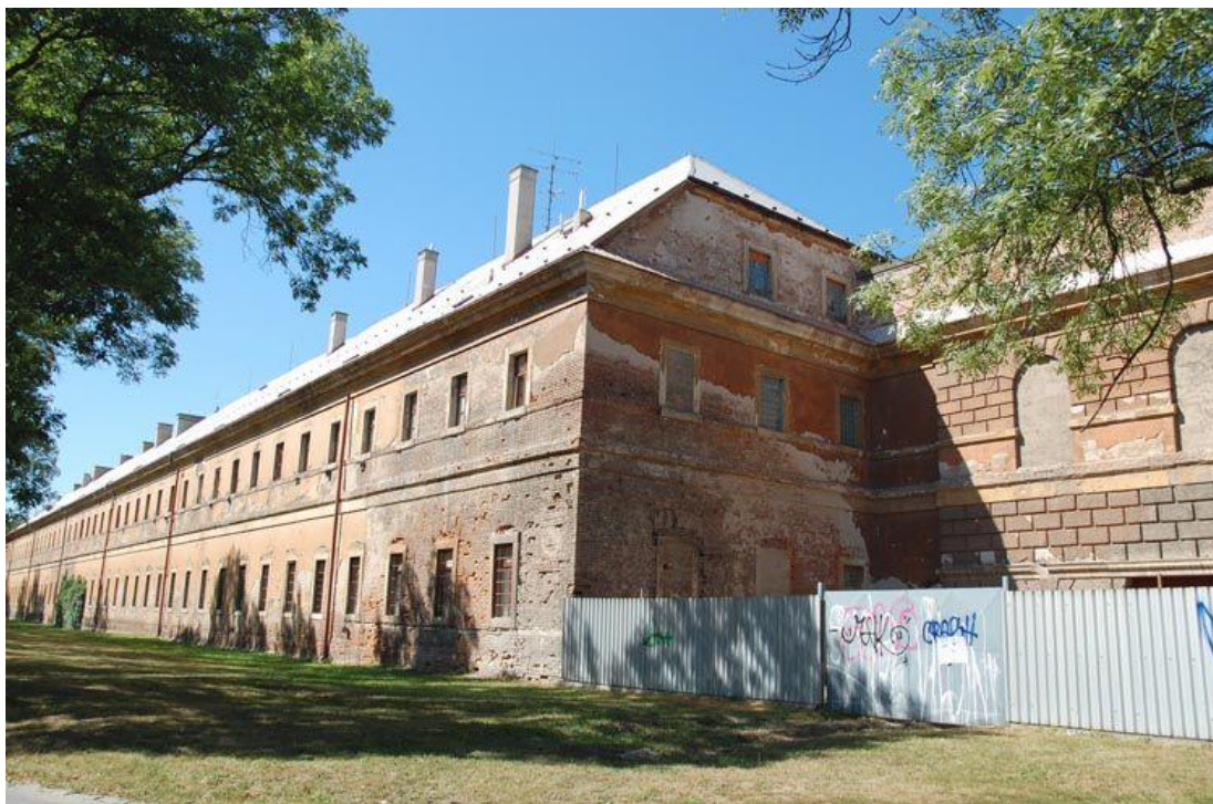
Obrázek 7 Katastrofální stav vnější fasády, stav k roku 2009 22
