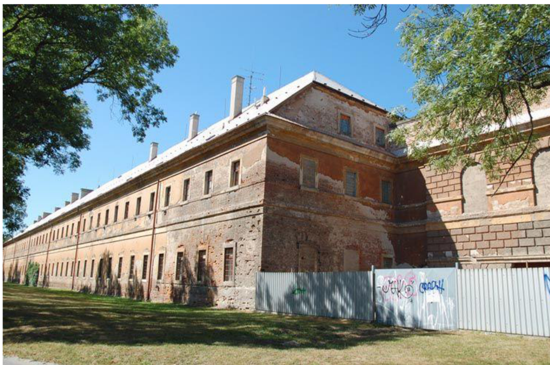
Obrázek 7 Katastrofální stav vnější fasády, stav k roku 2009 22
