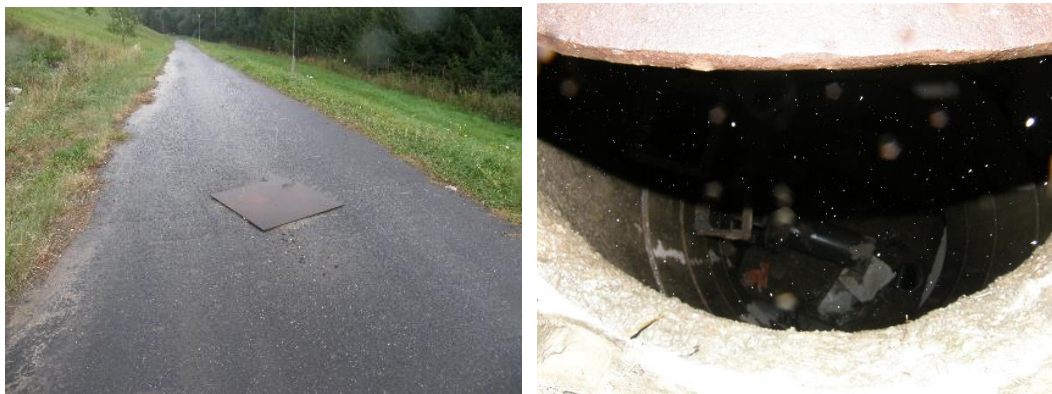
Obrázek 19: Kontrolní šachta čisté a průsakové vody
