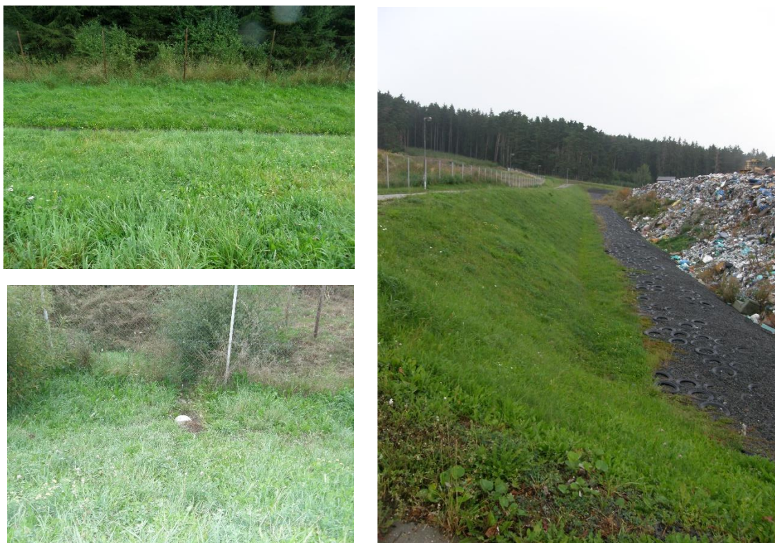
Obrázek 20: Odvodňovací příkop, vyústění do vodoteče, ochranná hráz s odvodňovacím příkopem proti vniknutí srážkové vody do tělesa skládky
