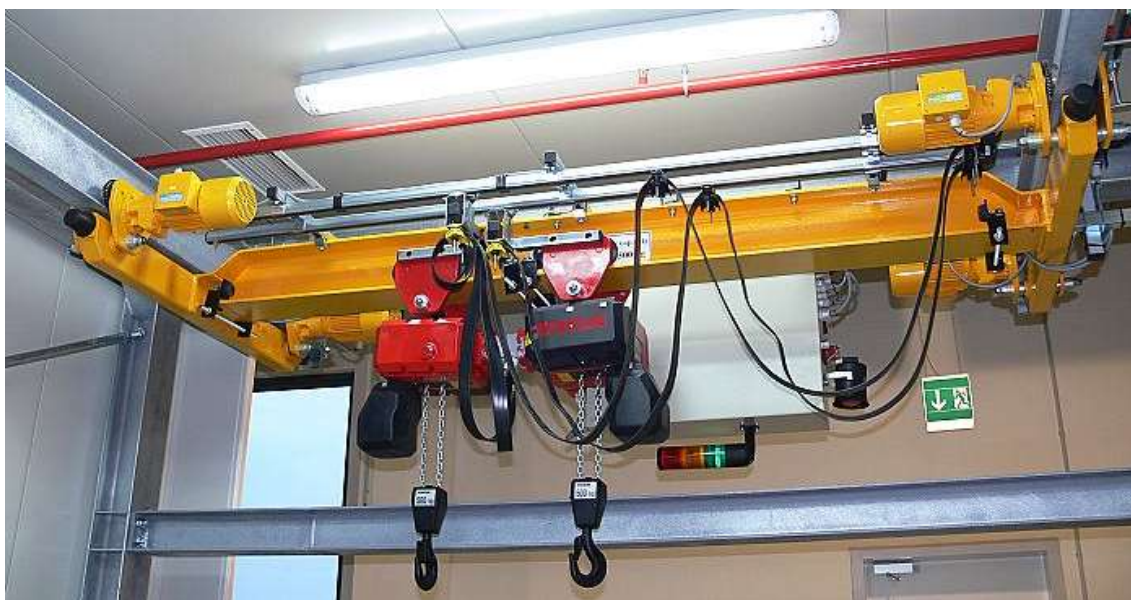
Obr. 4 Podvěsný mostový jeřáb jednonosníkový [19]
