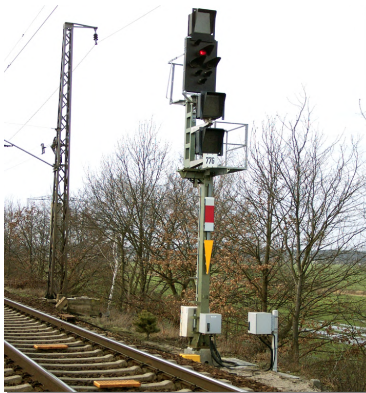
Obr. 1.1: Ukážka klasického zabezpečovacieho systému - Návěstidla. [1]
