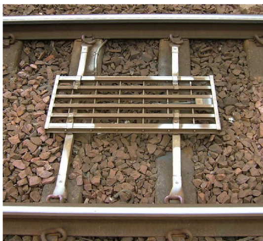
Obr. 1.6: Ukážka TPWS cievky na trati.
