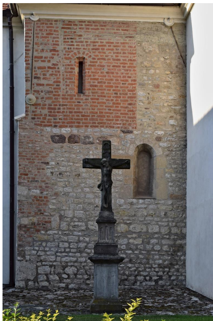
8. Brno-Komárov, kostel sv. Jiljí, severní stěna s odkrytým románským zdivem, přelom 12. a 13. století
