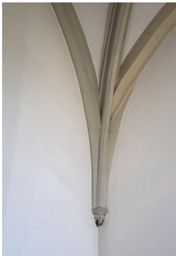
17. Brno-Komárov, kostel sv. Jiljí, presbytář – kružbová konzola poškozená při snížení závěru
