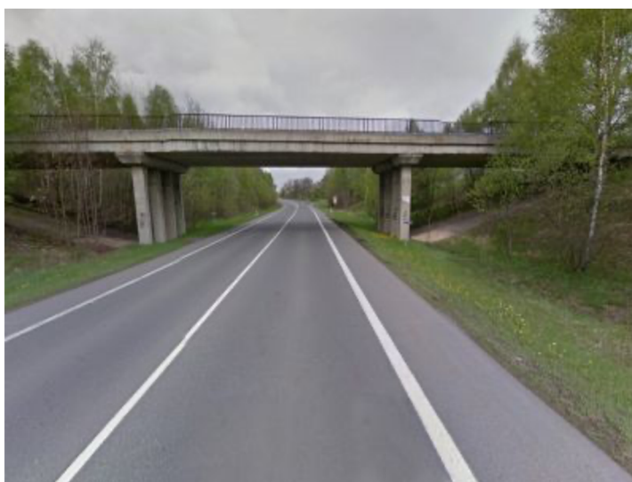
Obr. č. 12 Nechráněné mostní pilíře v blízkosti vozovky. Zdroj: Vymoly.cz: Nebezpečný úsek CZ7176 [online]. [cit. 7.9. 2022] Dostupné z: https://www.vymoly.cz/detail/silnice-i-20-u-touzimi-pilire-nadjezdu/
