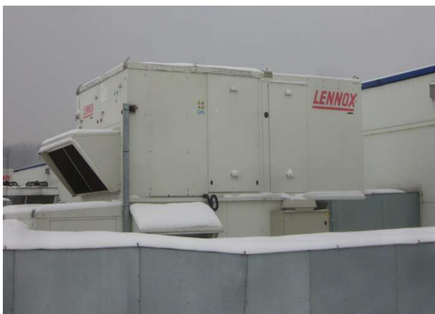
Obr.2: Nástřešní rooftopová jednotka
