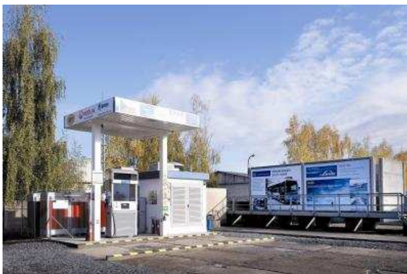
Obr. 9.: Celkový pohled na vodíkovou čerpací stanici
