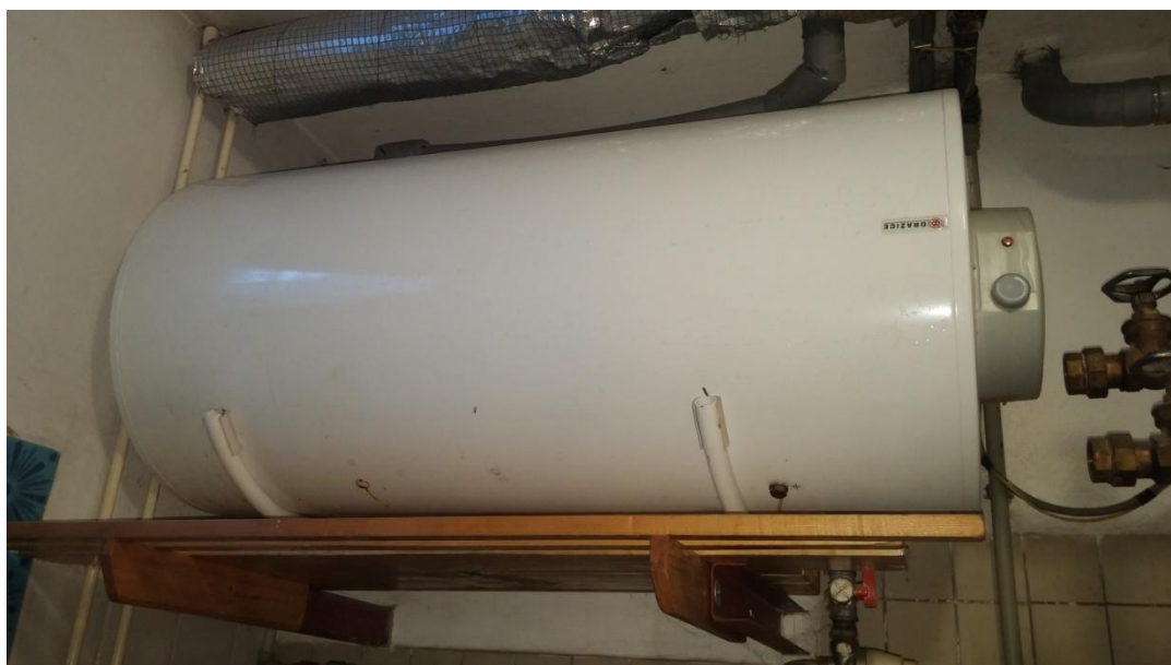
Obr. 17 – Zdroj teplé vody, elektrický bojler o objemu 200 l [zdroj: vlastní zpracování]
