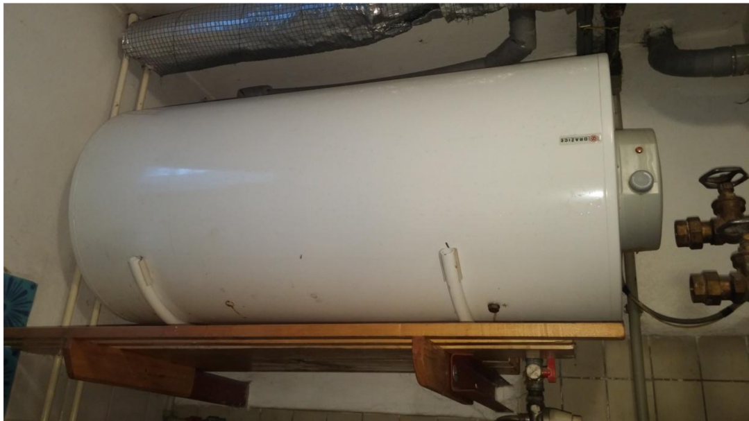
Obr. 17 – Zdroj teplé vody, elektrický bojler o objemu 200 l [zdroj: vlastní zpracování]
