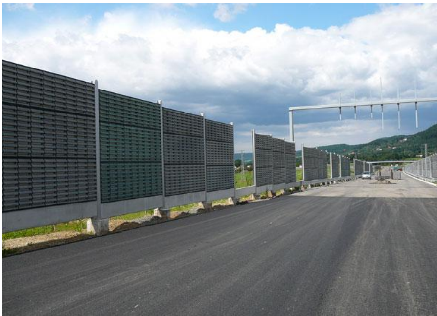
Obrázek 10 - Protihluková stěna z panelů z recyklovaných plastů [13]
