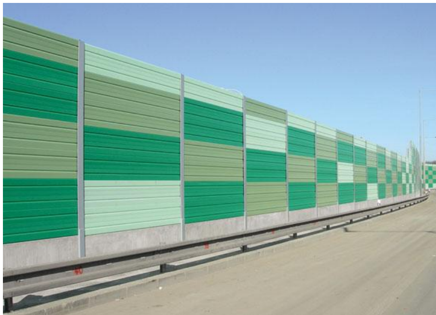
Obrázek 9 - Protihluková stěna z hliníkových panelů [13]
