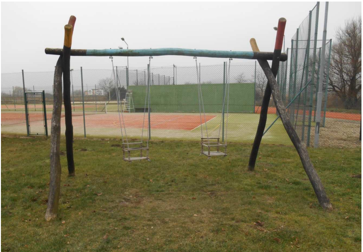
Opotřebení nátěru houpačky
