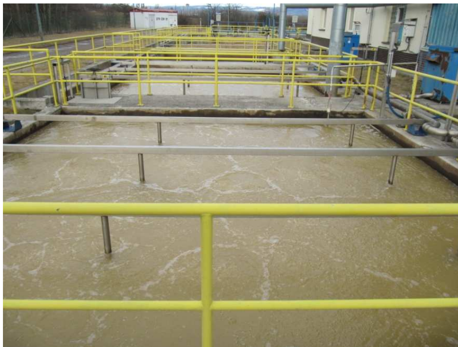
Fotografie č. 2 Sériově propojené aerační nádrže na ČDV Březno
