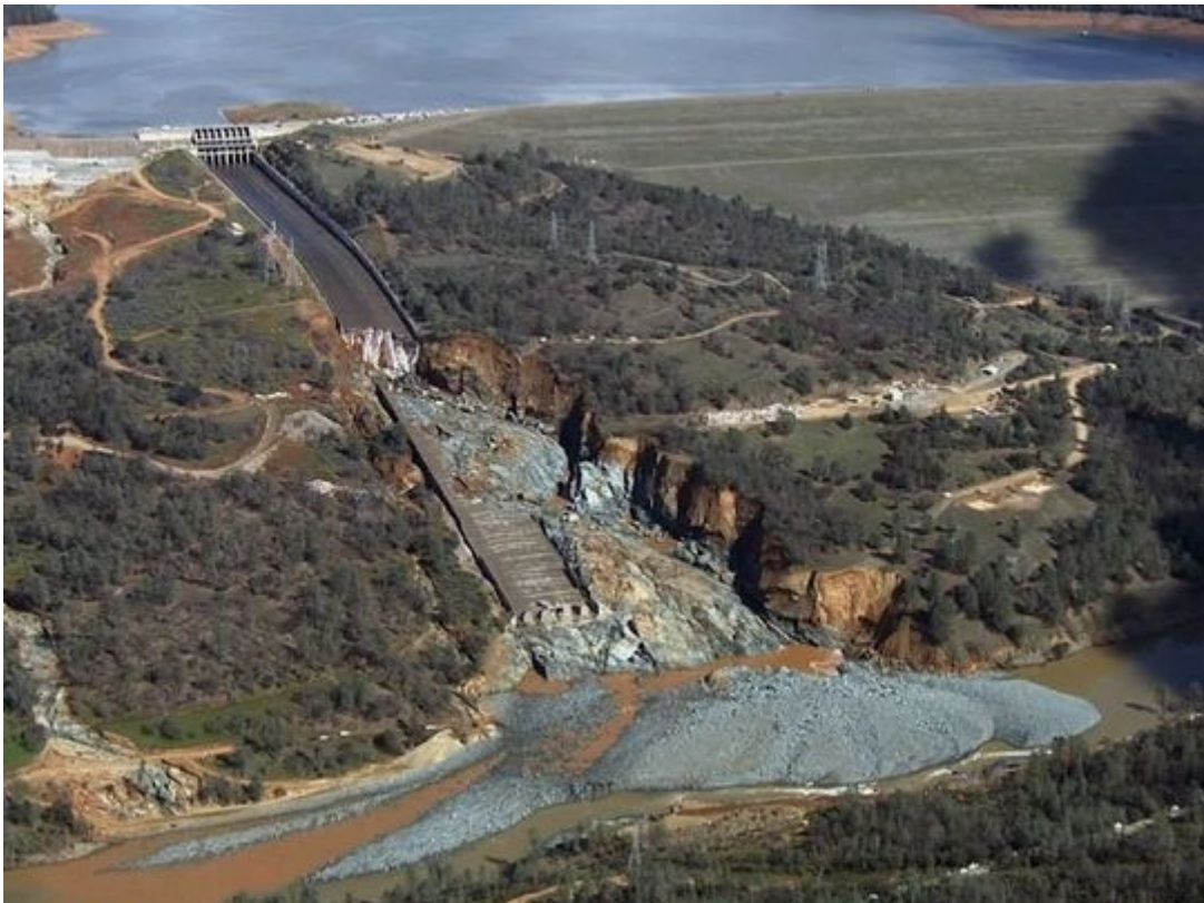
Obrázek 13. Poničený přeliv přehrady Oroville. Zdroj: https://eu.usatoday.com/story/news/nation-now/2017/02/28/oroville-dam-spillway-damage/98528880/
