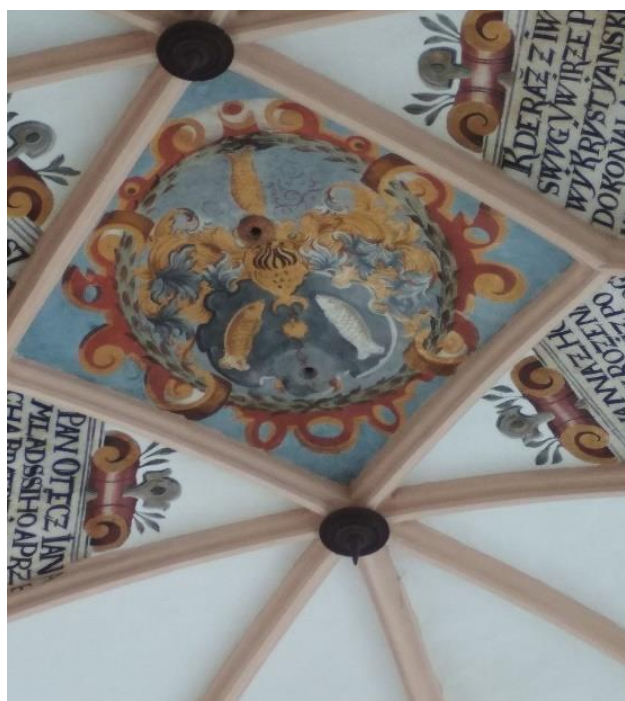
Obr. 10 Klenba milevského typu znak č. 1
