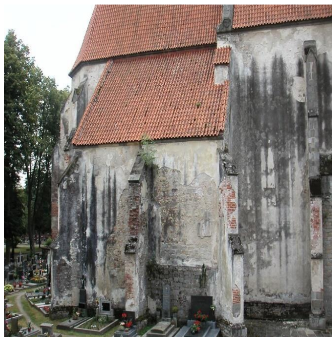
Obr. 4 Kostel sv. Jiljí a jeho fasáda před opravou
