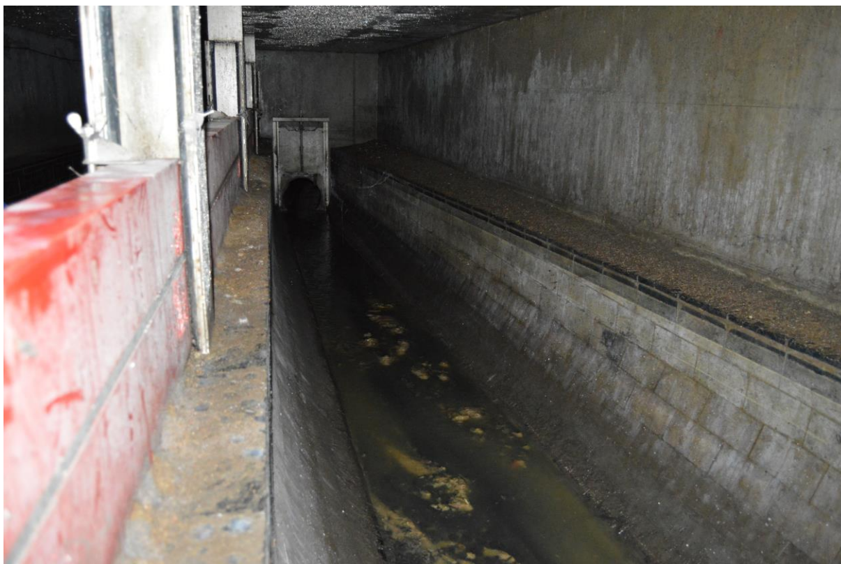
Obr. 6.3.3 Odtok splaškových vod na ČOV
