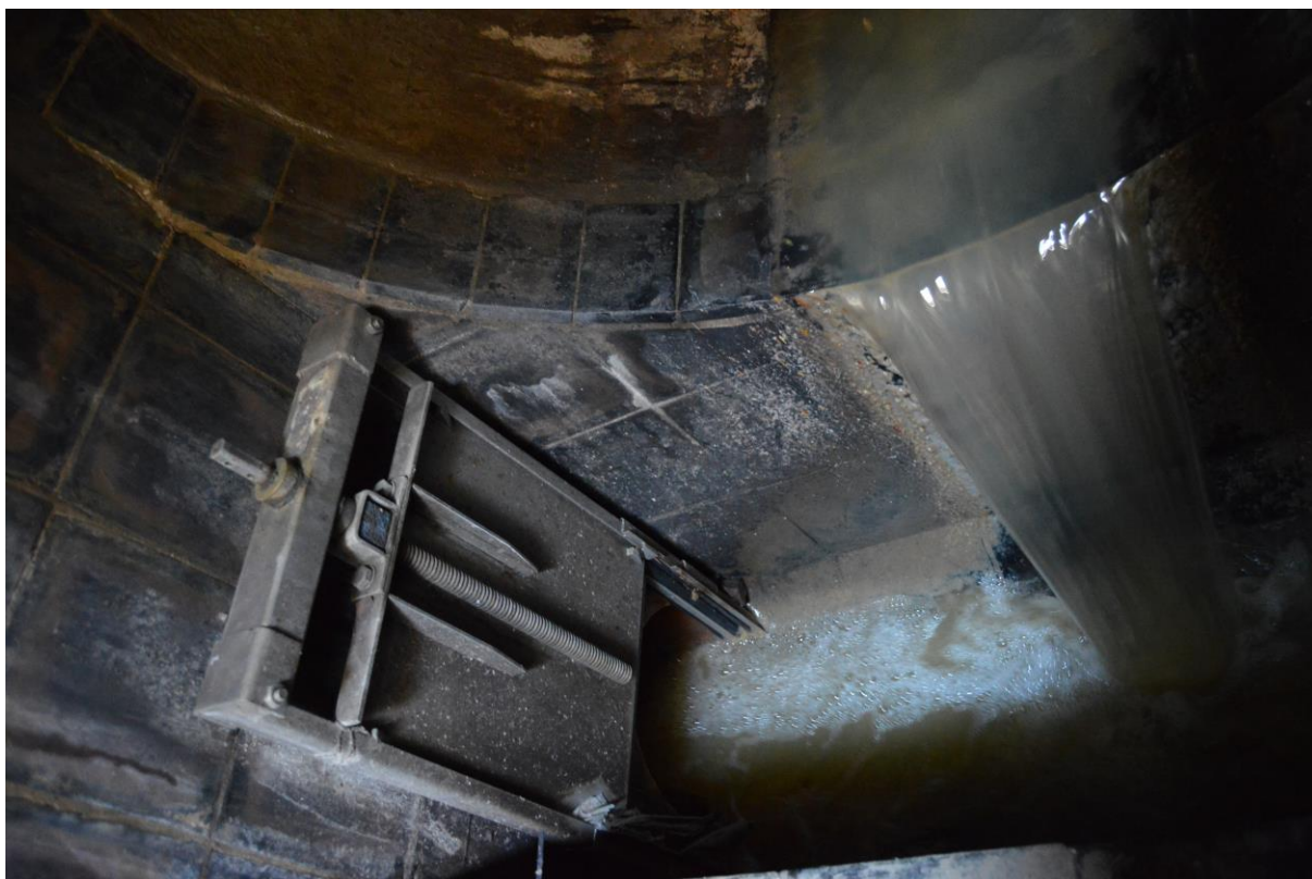
Obr. 6.1.4 Odtok splaškové vody na ČOV
