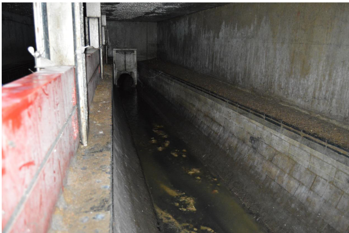
Obr. 6.3.3 Odtok splaškových vod na ČOV
