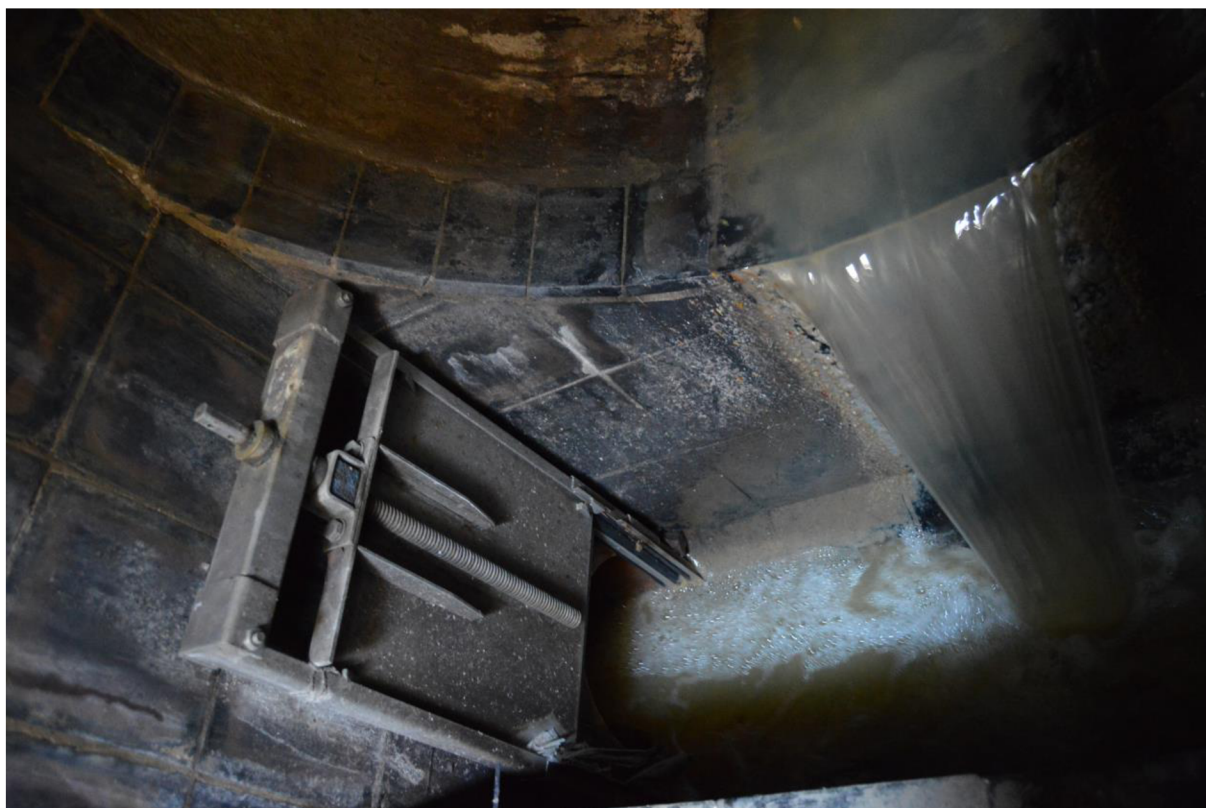
Obr. 6.1.4 Odtok splaškové vody na ČOV
