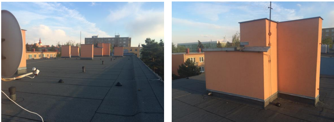
Obrázek 6 Současný stav střechy a staré expanzní nádoby
