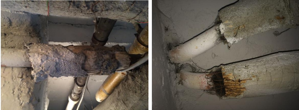
Obrázek 10 Detail ležatých rozvodů, izolace se nachází ve špatném stavu
