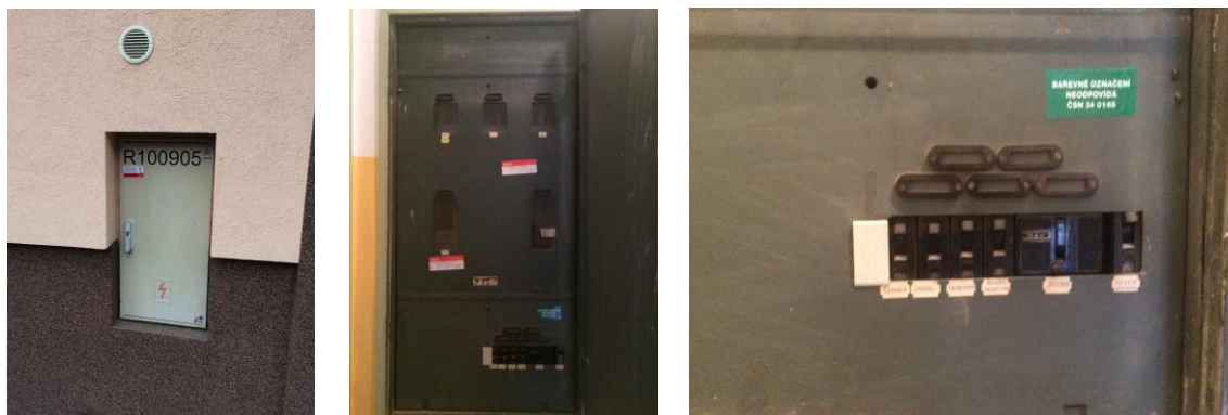
Obrázek 12 Elektroinstalace bytového domu a bytových jednotek
